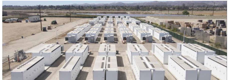
(*) Ejemplo de un parque de baterías Utility – Scale
