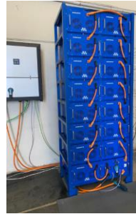
Fig 1. Batería ST160 kWh. Cliente Sapiens Energy.
